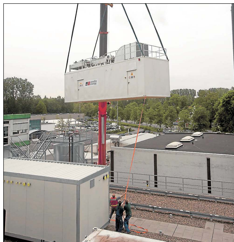
Auf dem Dach der Brotfabrik ist das Blockheizkraftwerk installiert worden. Bild: Mestemacher
