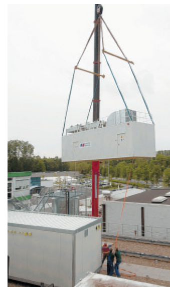
Herausforderung: Per Kran wurden die Container, in denen die Aggregate untergebracht sind, auf das Dach des Firmengebäudes gehievt. FOTO: MESTEMACHER
