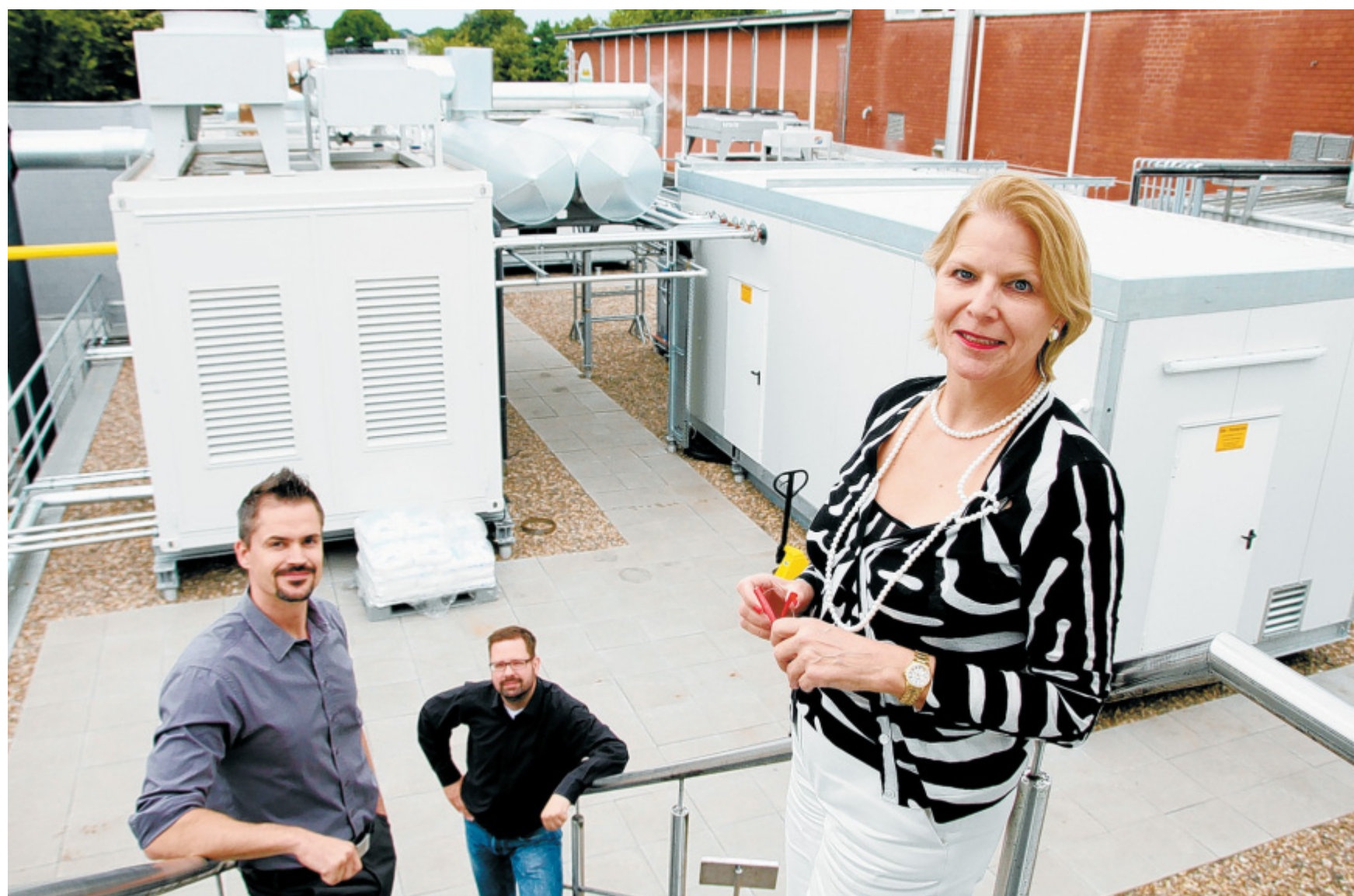
Eigene Energieversorgung: Prof. Dr. Ulrike Detmers, Mitglied der Geschäftsführung und Gesellschafterin der Mestemacher-Gruppe, Kim Folmeg (l.), Leitung Produktion, Technik, Produktentwicklung und Qualitätssicherung sowie Betriebsleiter Maik Detmers mit dem Blockheizkraftwerk, das auf dem Firmendach Strom und Wärme produziert. FOTO: GANS
