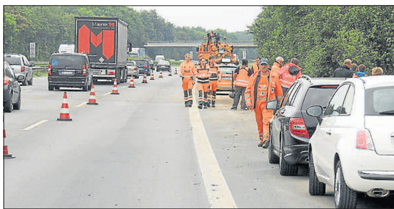
Am Montag musste für die Aufräumarbeiten auf der A 2 erneut eine Fahrspur gesperrt werden.
